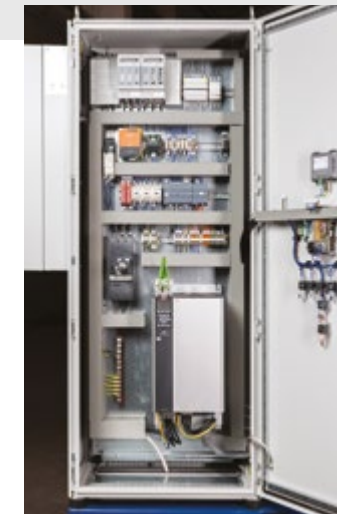
Armario de control con convertidor de frecuencia
